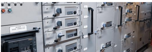
Siemens Sivacon 8PT
